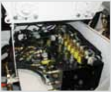
Système maison de contrôle de l'hydraulique
